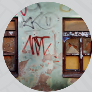
DETERIORAÇÃO DOS CENTROS TRADICIONAIS
